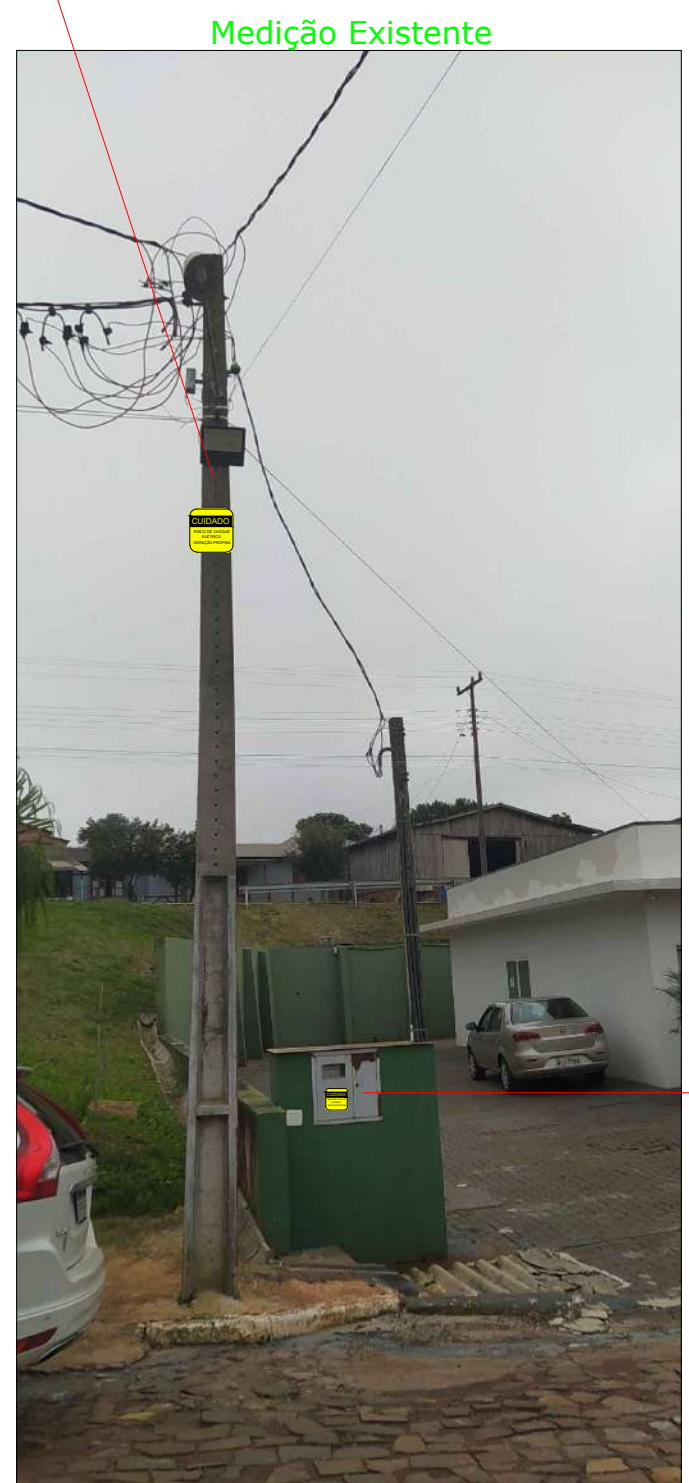
Medição Existente * Livre acesso
