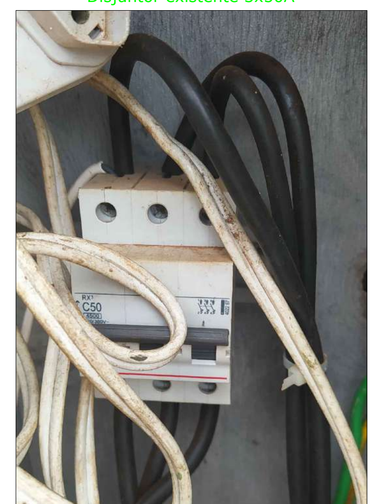
Disjuntor existente 3x50A
